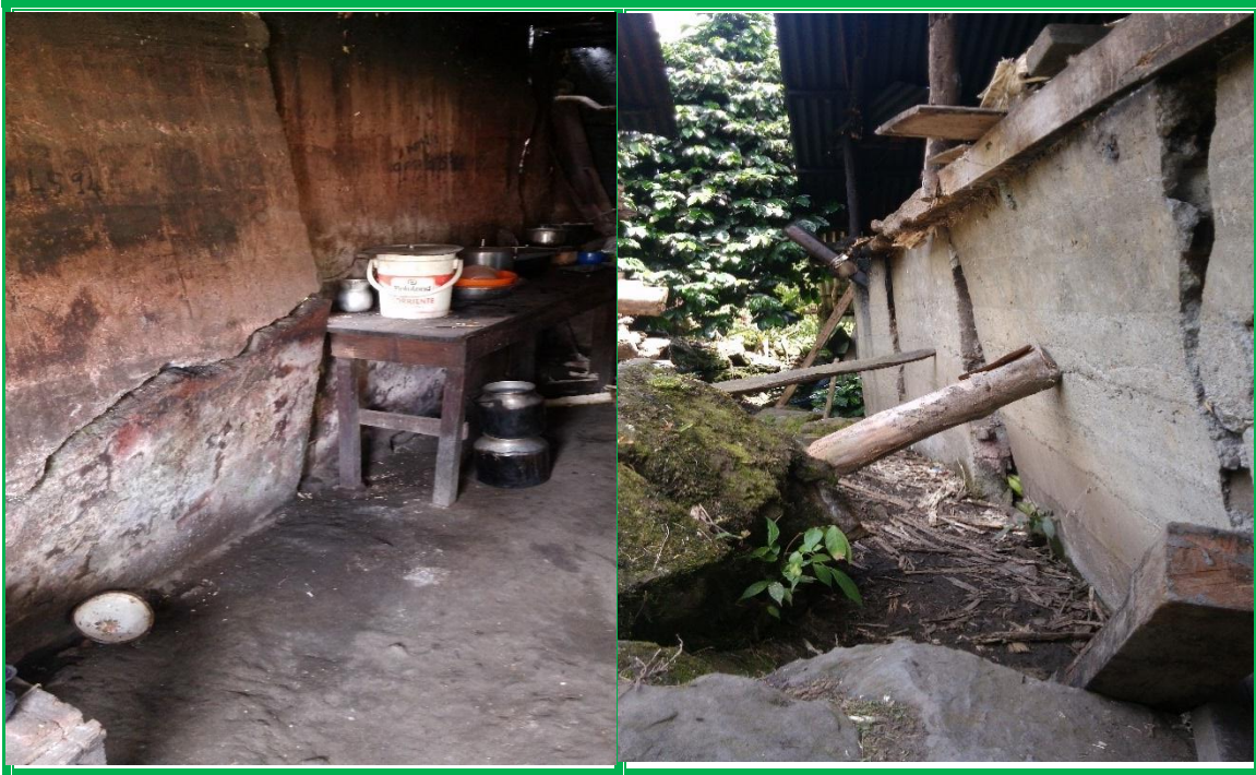
Fotografía 10. Vivienda En Riesgo Vereda La Agencia
